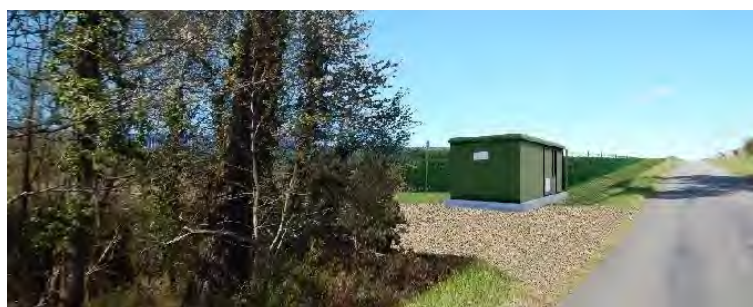
Figure 14 : Exemple de modélisation d'un local technique
